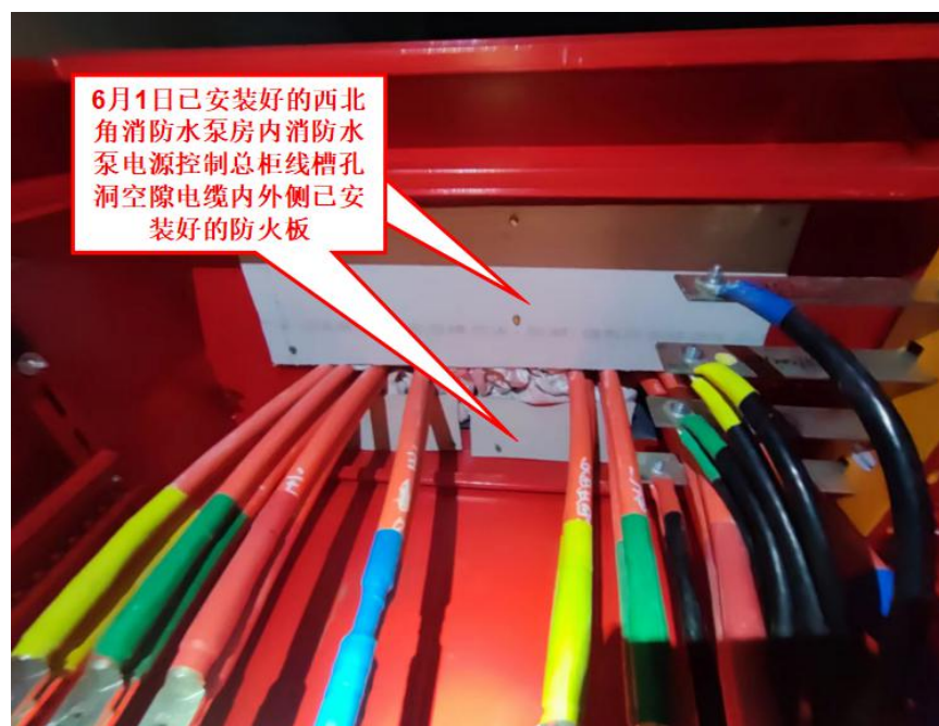
图 18 事发消防水泵房西北角消防水泵控制间消防水泵控制柜线槽孔洞封堵情况勘查图
