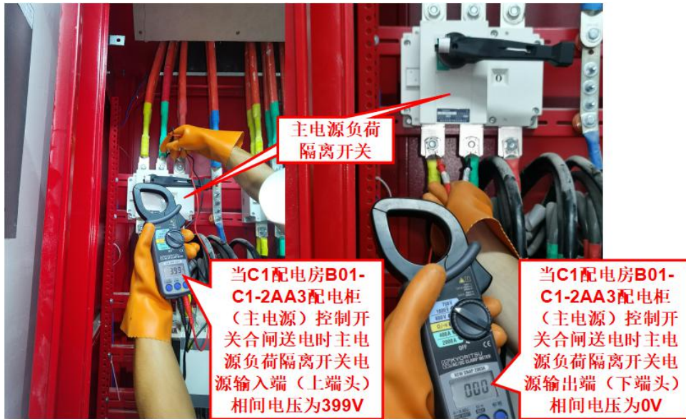
图 15 当 C1 配电房 B01-C1-2AA3 配电柜（主电源）控制开关合闸送电时，主电源负荷隔离开关电源输入输出端相间带电情况勘查图
