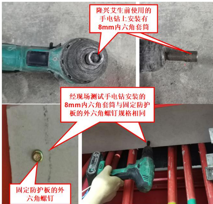
图 12 事故现场手电钻及固定防火板的外六角螺钉规格 勘查图
