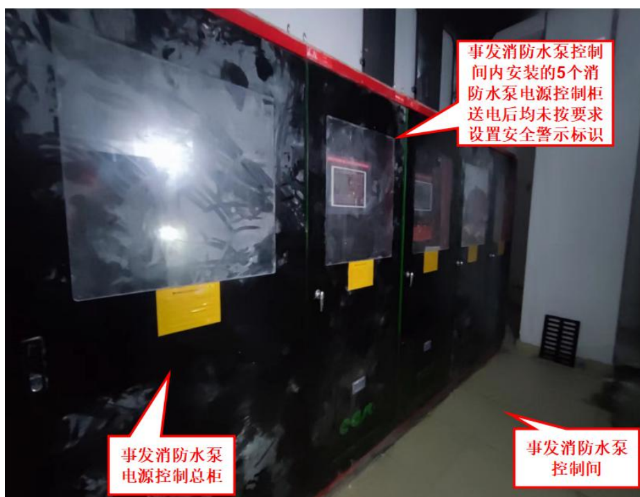
图 17 事发消防水泵控制间内安装的 5 个消防水泵电源控制柜送电后安全警示标识设置情况勘查图
