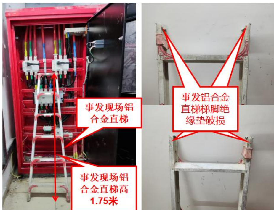
图9 事发消防水泵电源控制总柜内勘
